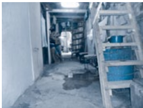
Izquierda y arriba: fugas de aguas residuales llenan los pasillos y provocan un riesgo a la salud para los residentes Foto: Calixto Ramón Martínez Arias
