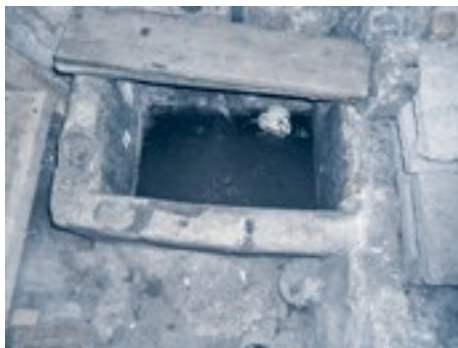
Vertedero de agua bloqueado en San Martín 688.
